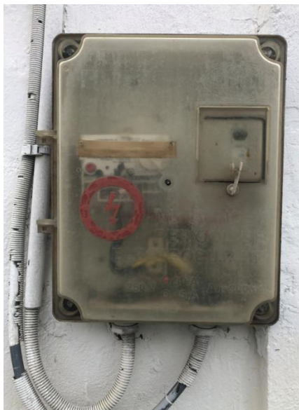
Bloc de măsură și protecție monofazat, amplasat de pe fațada turnului
