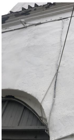
Instalația electrică de iluminat din exterior - este nefuncțională
