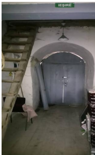
Aparat de iluminat parter turn respectiv iluminat de siguranță pentru evacuare marcat prin etichete lipite pe perete
