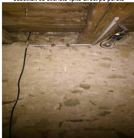
Aparat de iluminat din pod, alimentat printr-un circuit în montaj aparent.
