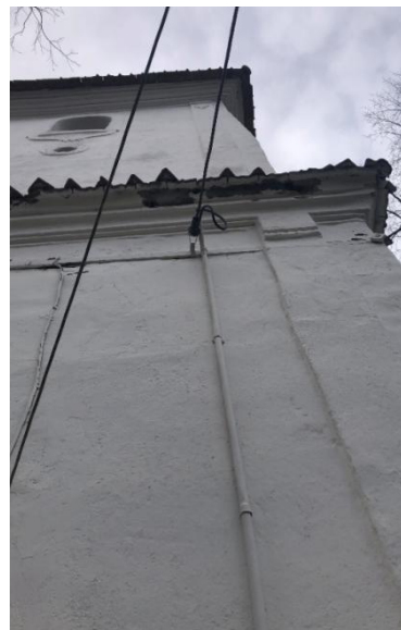
Linie electrică aeriană și traseu aparent pentru coloana de alimentare a BMPM-ului
