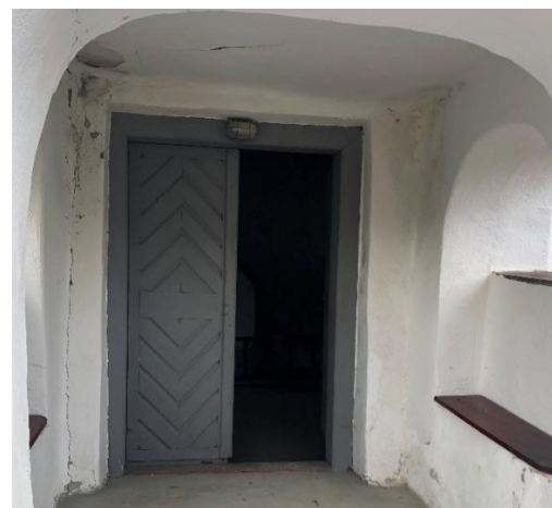
Instalația electrică de iluminat din portic - este nefuncțională
