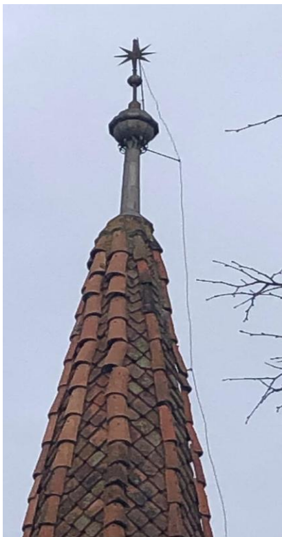
Instalație de paratrăsnet clasică, montată pe turnul bisericii
